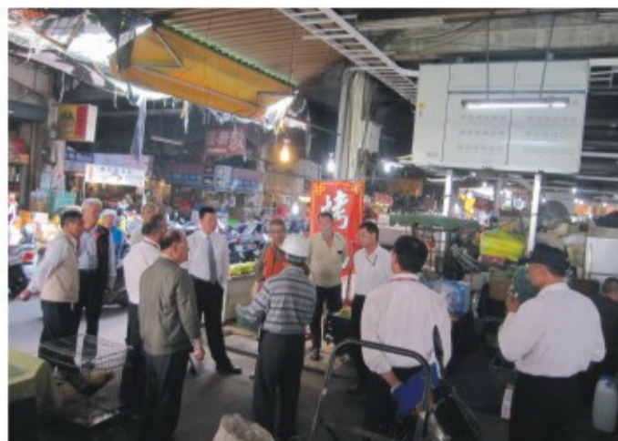
▲場內電源設備重新更新裝設現場驗收情形。
