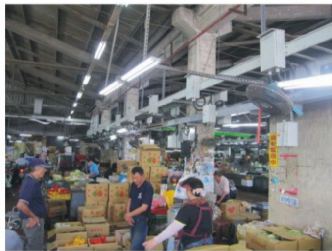
▲更新後場地穩定供電，且各承銷人採單線單錶設置，獲現場承銷人支持及肯定。
